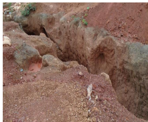
Photo 9 : risque d'affaissement du substrat
