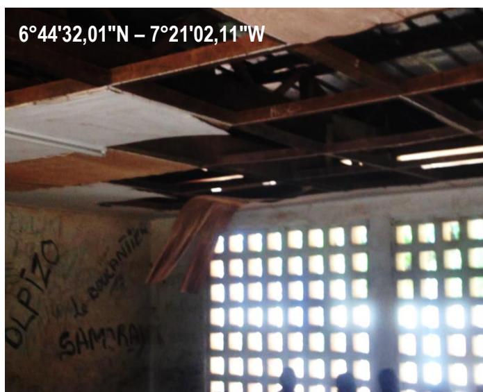
Photo 1: État dégradé des salles de classe du Lycée Moderne Duékoué
